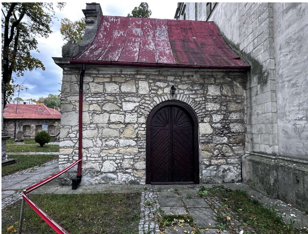
Fot. nr 11 XVII kościół p.w. Nawiedzenia NMP zespołu klasztornego OO. Franciszkanów w Pińczowie. Widok wtórnych zapraw cementowych w strefie spoinowania wątków kamiennych kruchty zachodniej.
