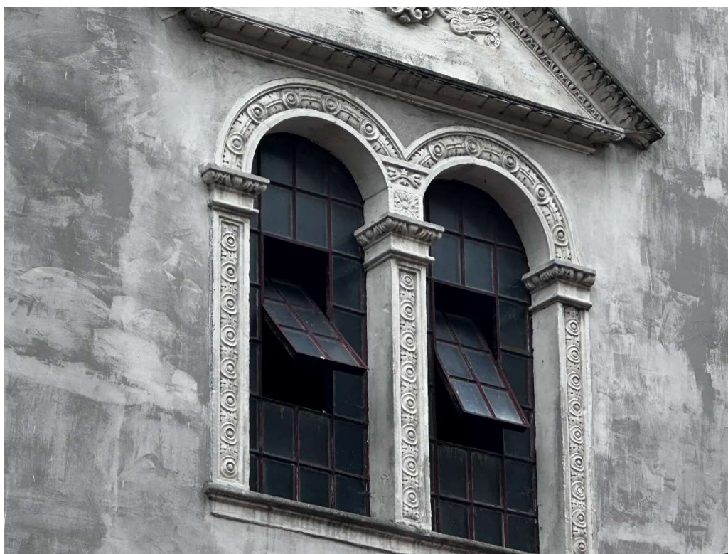
Fot. nr 12 XVII kościół p.w. Nawiedzenia NMP zespołu klasztornego OO. Franciszkanów w Pińczowie. Widok wtórnych warstw malarskich na powierzchni kamiennej biforium elewacji frontowej.
