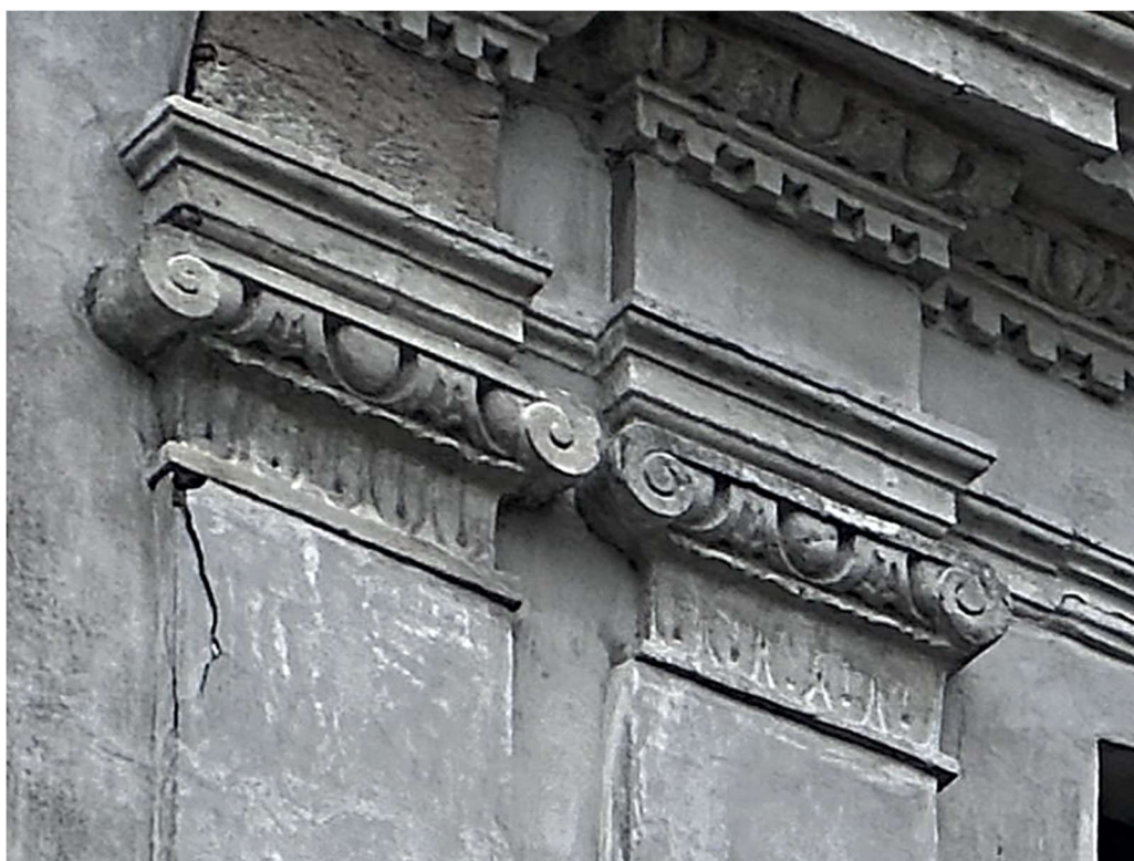
Fot. nr 7 XVII kościół p.w. Nawiedzenia NMP zespołu klasztornego OO. Franciszkanów w Pińczowie. Widok ciemnych nawarstwień na powierzchni kapiteli pilastrów elewacji frontowej.
