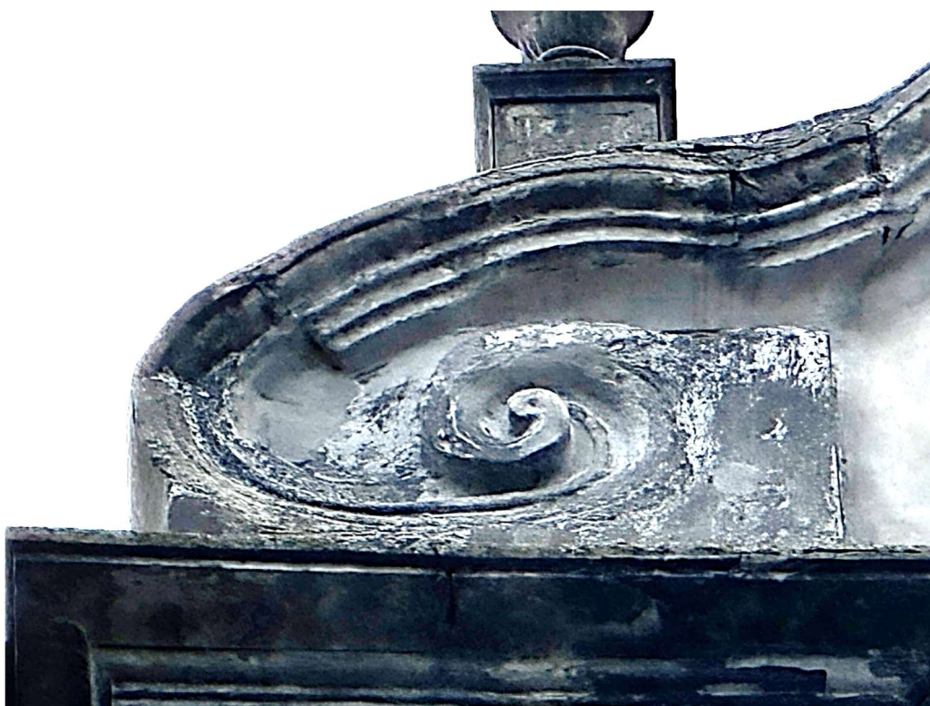
Fot. nr 6 XVII kościół p.w. Nawiedzenia NMP zespołu klasztorowego OO. Franciszkanów w Pińczowie. Widok uszkodzenia mechanicznego fragmentu gzymsowania ślimacznicy.
