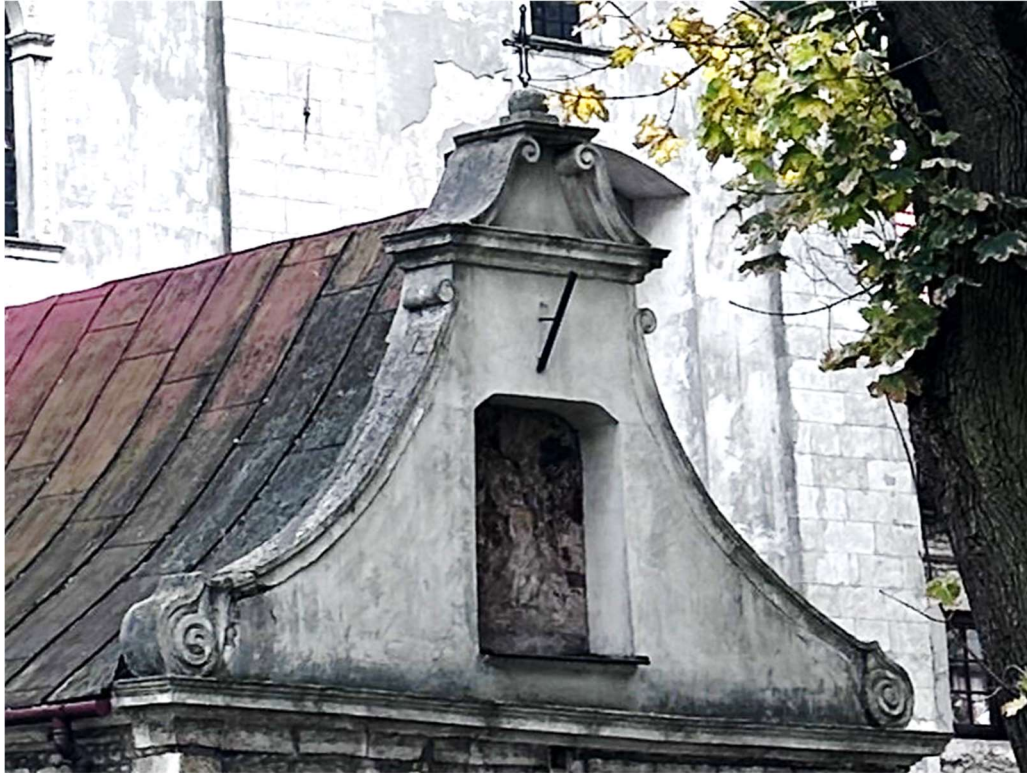
Fot. nr 8 XVII kościół p.w. Nawiedzenia NMP zespołu klasztornego OO. Franciszkanów w Pińczowie. Widok porażenia mikrobiologicznego spływów frontonu kruchty.
